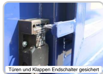
Türen und Klappen Endschalter gesichert
